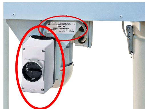
Bild 5.3.5: Motorschutzschalter mit Reparaturschalter
